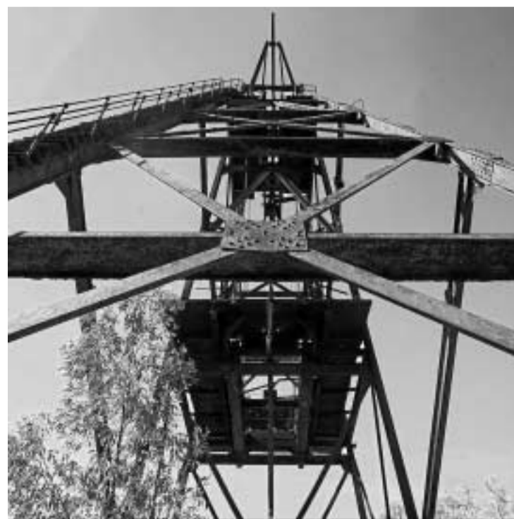
Detalle del castillete del pozo número 4 en la Corta de los Silos en La Zarza, Calañas (Huelva).
